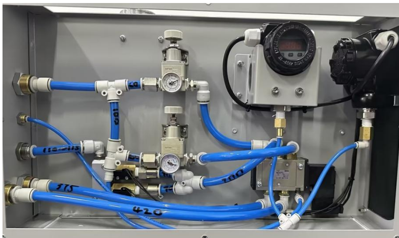
图 2-5 M 型防爆电柜内部的气路结构
