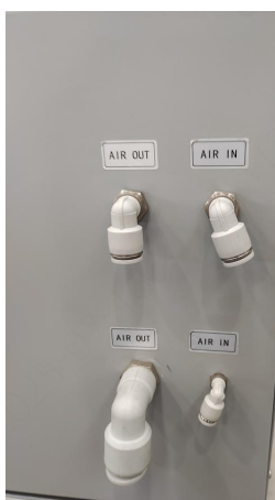
图 2-5 防爆柜气管接口
