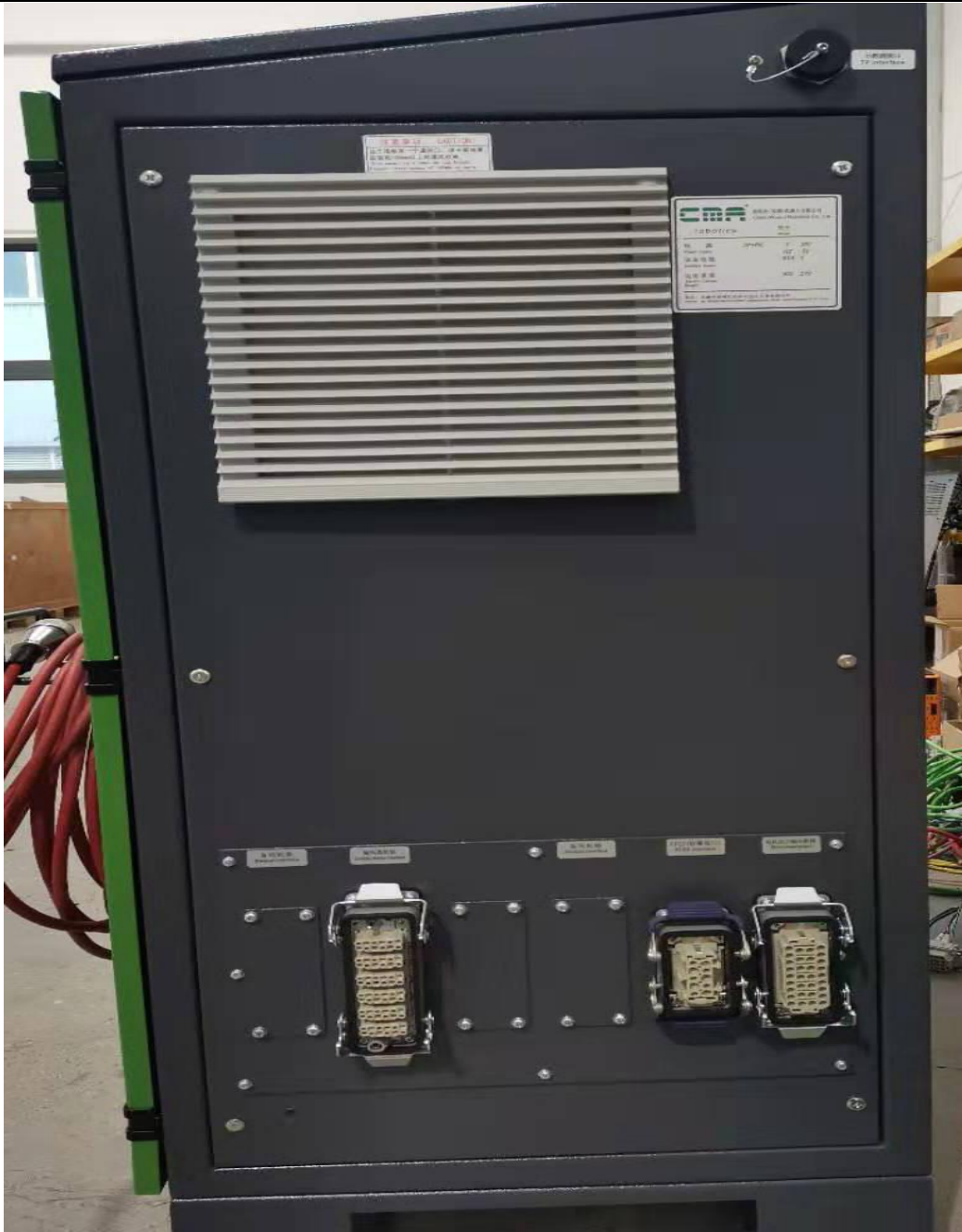
电柜右侧面相关元器件布局与安装
