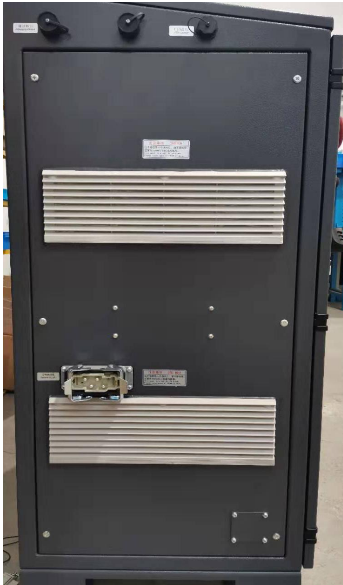
电柜左侧面相关元器件布局与安装
